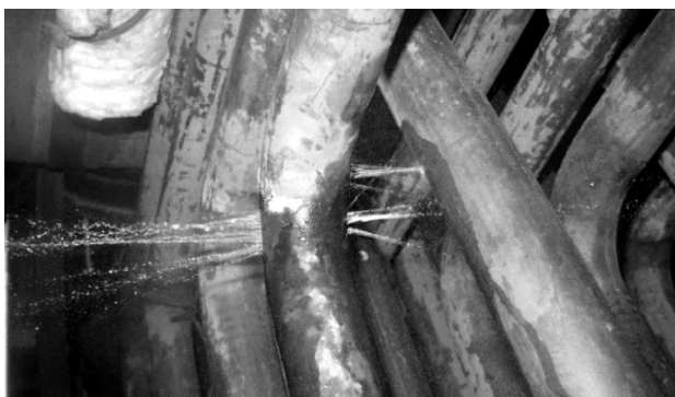
Figure 4: Leakage on superheater-P2 pipe bend Slika 4: Puščanje na P2 pregrevalniku na krivini cevi
