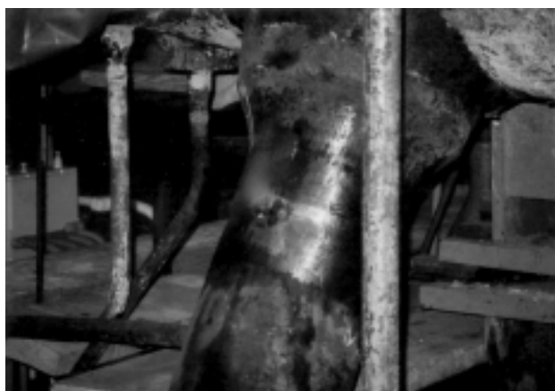
Slika 1: Makroposnetek zvara na regulacijskem ventilu s parovodom na turbini visokega tlaka
